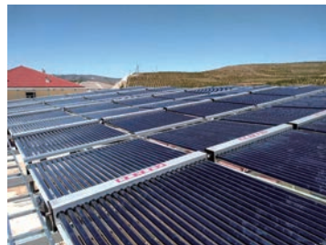
改造后的太阳能电辅热锅炉
