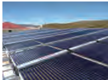
改造後的太陽能電輔熱鍋爐
