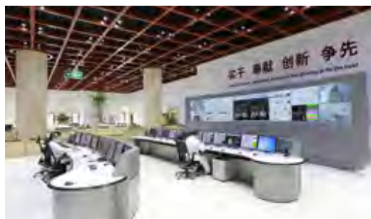
北京燃氣集控中心
