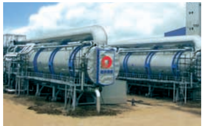
黃驊電力海水淡化裝置
