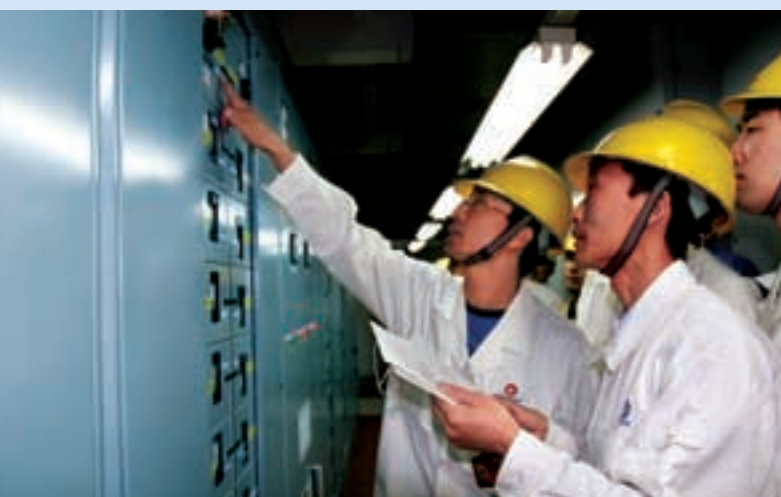
檢查電廠運行設備
